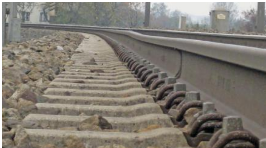
Obrázok 1-19 Rozdiel v sadaní na prechode z úseku s podpodvalovými podložkami na úsek bez podložiek s chybou v polohe koľaje
