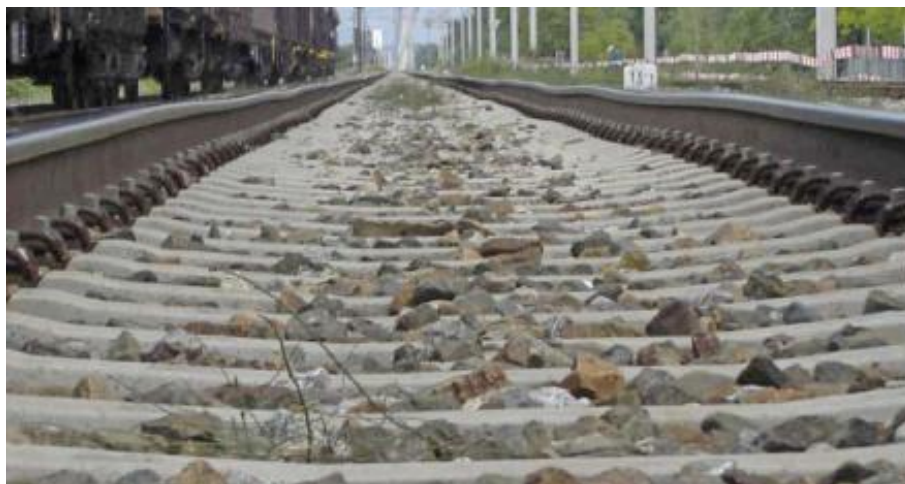
Obrázok 1-11 Chyby geometrického usporiadania koľaje spôsobené nerovnomerným sadaním železničného spodku
