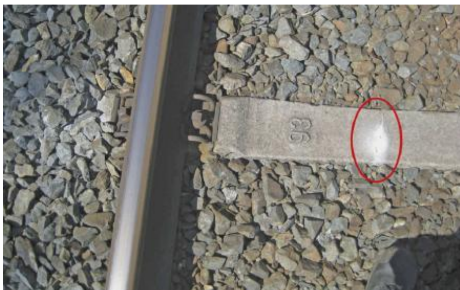
Obrázok 1-10 Podval s priečnou trhlinou v dôsledku zvýšeného ohybového namáhania
